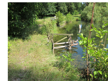
5 - technische Anlagen/ Auslässe
